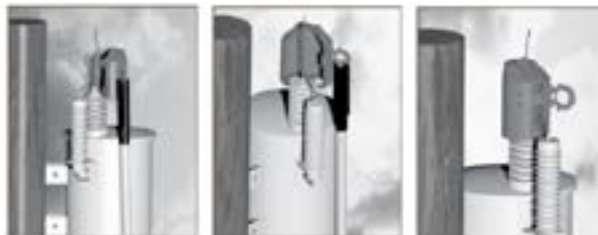
Mit dem «Hot Stick» ist eine Montage unter Spannung möglich
