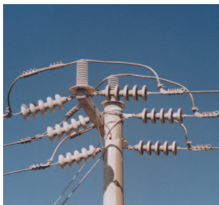
Stützisolatoren und Kappenisolatoren an einer Freileitung
